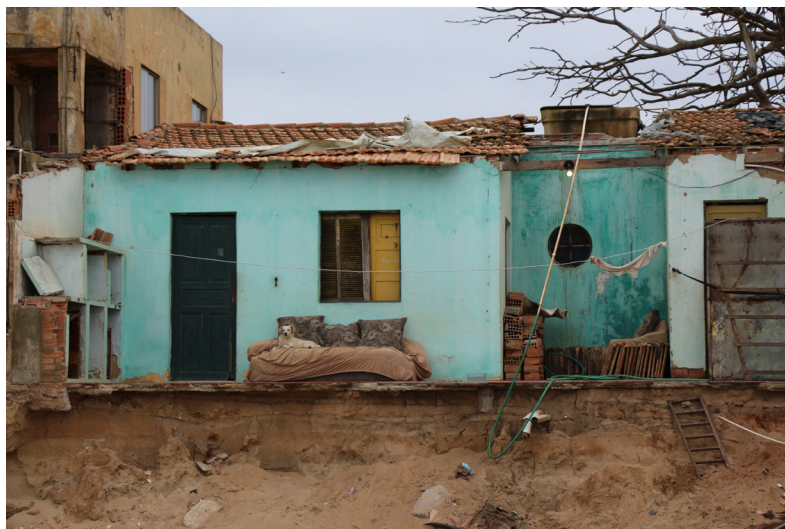
Figura 12. Casa atingida pela erosão, com um cachorro deitado no sofá observando a praia
