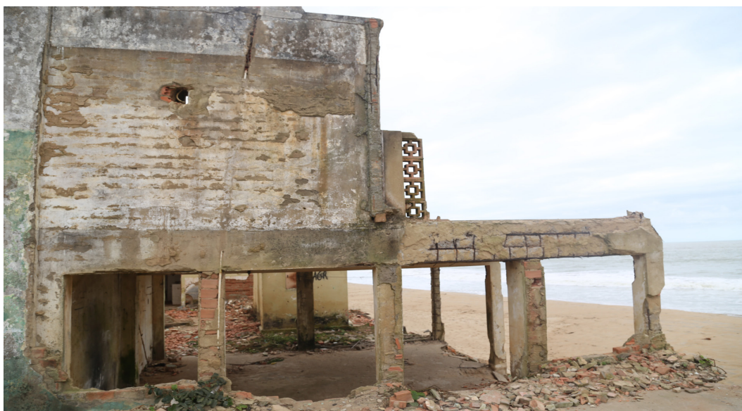
Figura 8. Casa atingida pelo processo de erosão
